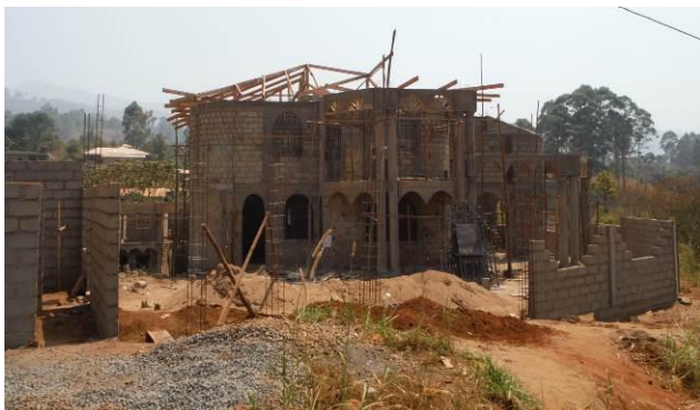
Photo 18 : Pk0+650 : Chantier en cours dans l'emprise de la route voie de contournement
