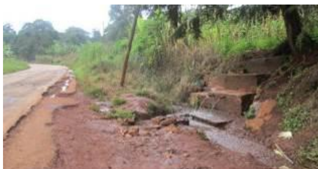
Photo 2 : Pk 3+700 Point d'eau aménagé dans l'emprise : restriction d'accès à la ressource en eau
